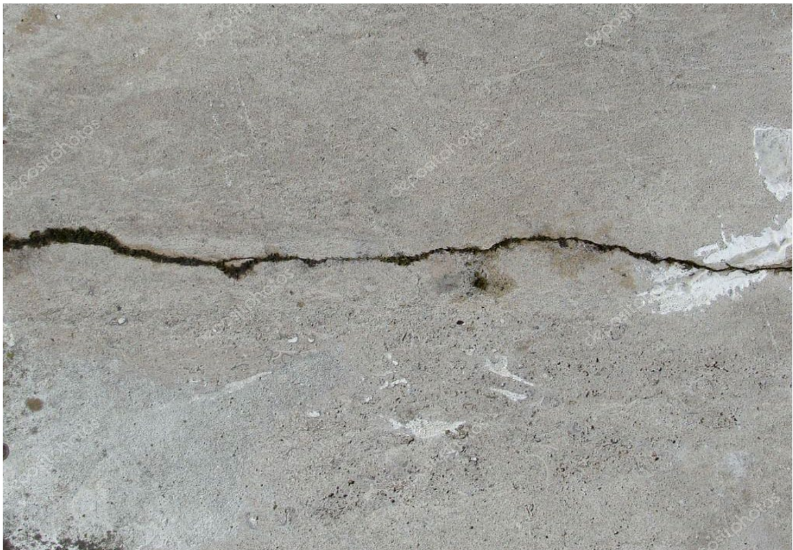
Мал. 1. Типова тріщина в асфальтобетонному покритті
